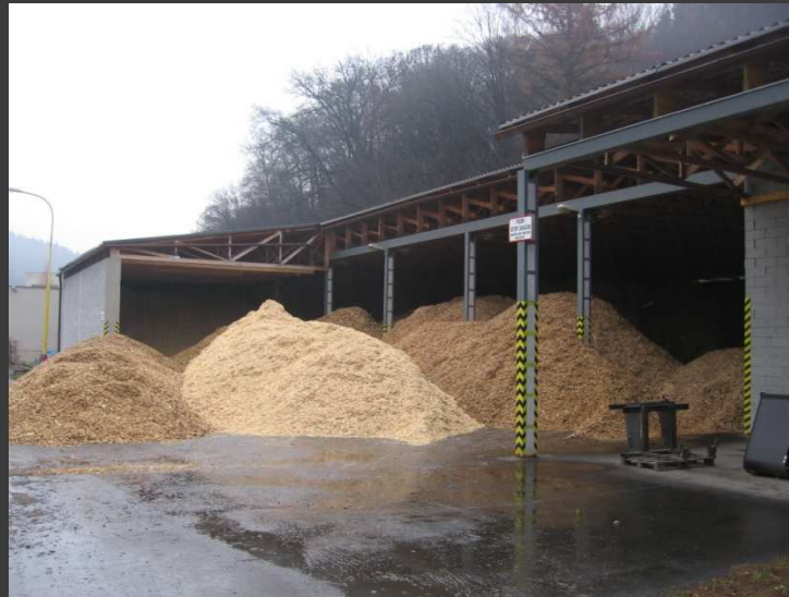
Instalace parního kotle na štěpku.
